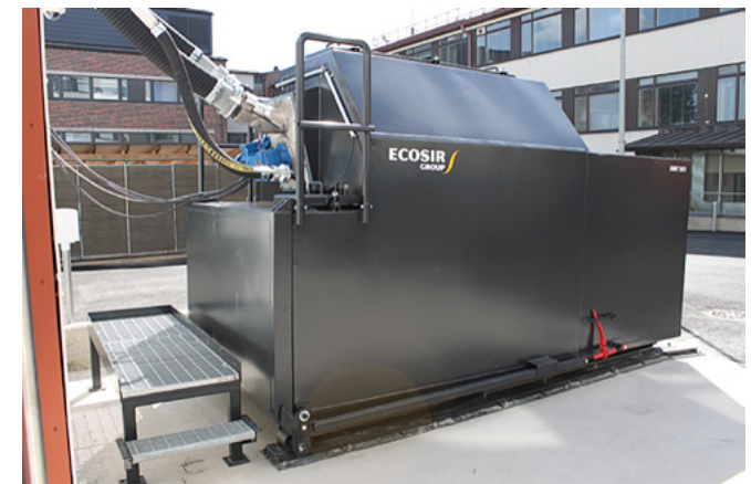
Vakuumkontainer for avfall (utendørs)
