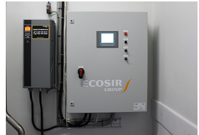
Kontrollenhet og frekvensomformer for vakuumsystemet
